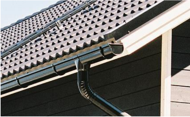
Kuva 1. P13 kouru ulkopuolisella kannakkeella ja liukulähtö
